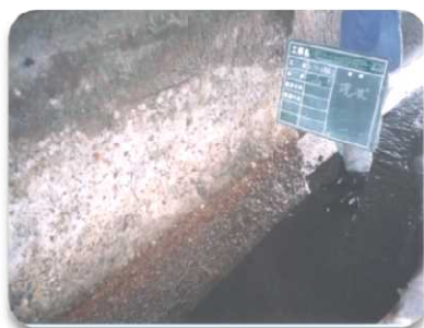
施工前 (劣化状況)
