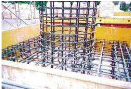
写真:「弁天橋」橋脚部配筋 (福島県いわき市久之浜波立海岸)
