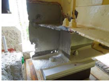
腐食状況（ケレン後）
