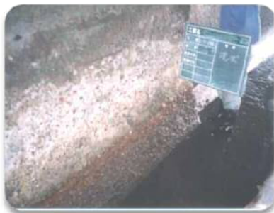
施工前 (劣化状況)
