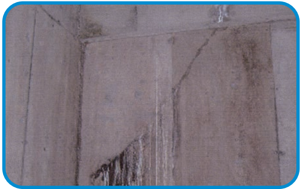
ひび割れからの漏水
