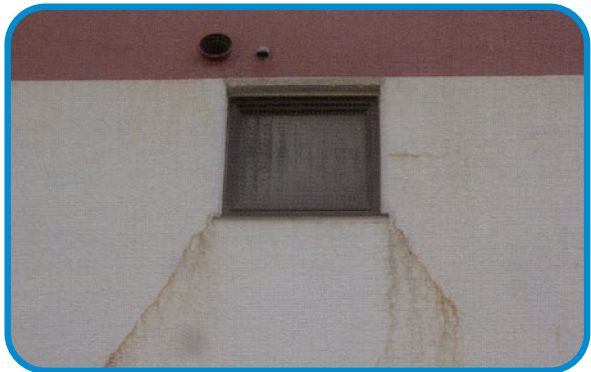
外壁のひび割れ
