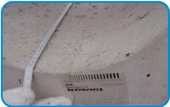
コンクリート構造物のひび割れ
