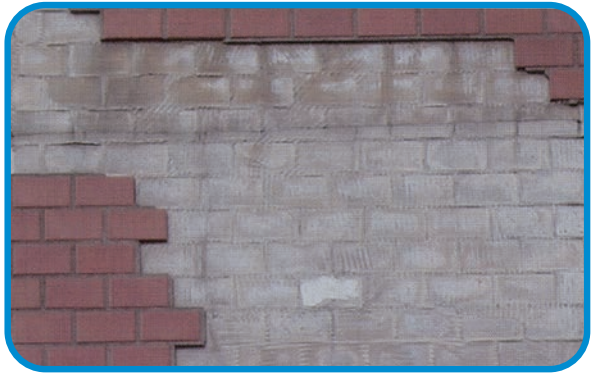
タイル張り外壁の浮き
