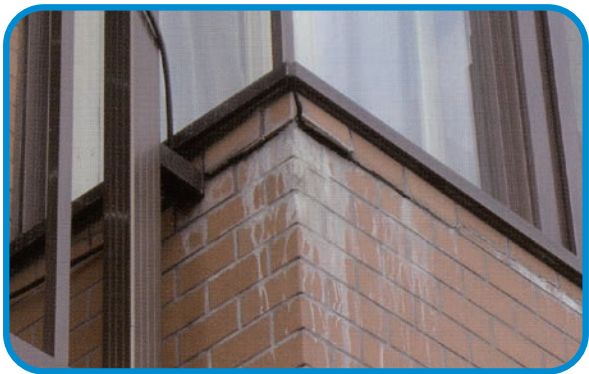
サッシ廻りタイルの浮き
