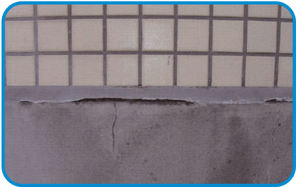
シーリング材の劣化・剥離
