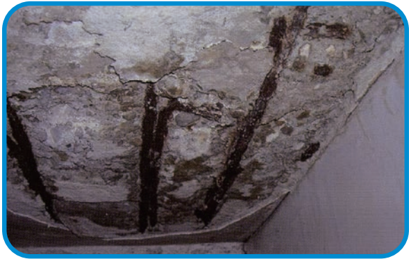
コンクリートの露筋、欠損
