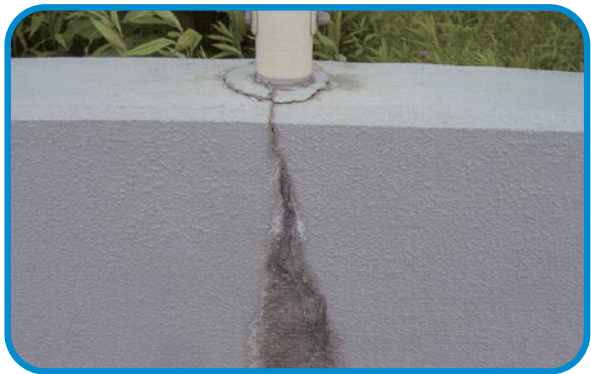
手摺り部分のひび割れ
