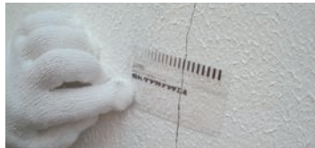
2. ひび割れ測定
