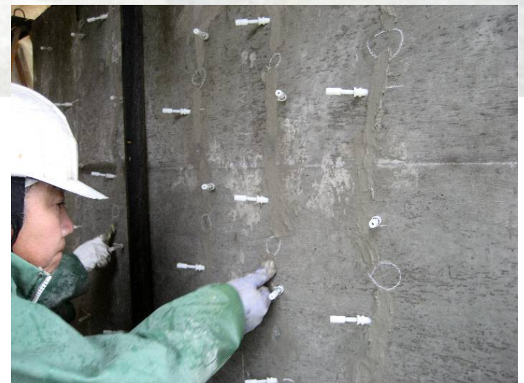
急結セメントによる ひび割れシール状況
