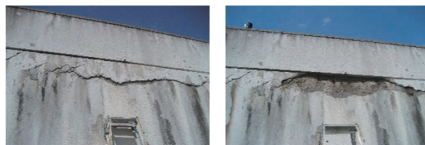
露筋欠損等で構造物の耐力低下につながる可能性がある。
